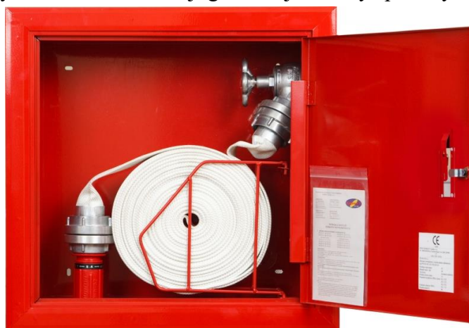
Hydrant wewnętrzny 52 z wężem płasko składanym w koszu węzowy.
